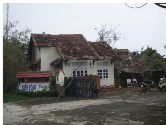
Hình 4. Khu du lịch resort Biển Đông bị hư hại sau bão tại bán đảo Sơn Trà, TP. Đà Nẵng
